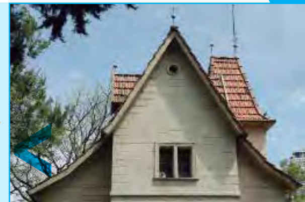
Vista del hastial con ventanas y ojo de buey. Se observan también las agujas de remate de la cubierta.
